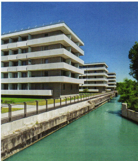
Durch den Einsatz von circa 15 000 Quadratmetern Doppelwand und 14 000 Quadratmetern Elementdecke wurde die Bauzeit verkürzt.
